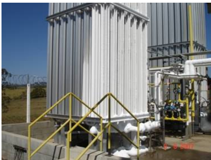
Figura 4: Vaporizador do terminal de regaseificação de Andradadas.
