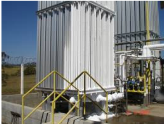
Figura 3.7 - Vaporizadores atmosféricos, (planta de regaseificação em Andradás, MG, 2007).
