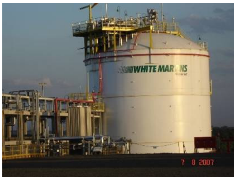
Figura 2: Tanque de armazenamento de GNL da planta de liquefação de Paulínia.
