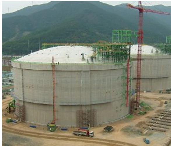
Figura 2.5 - Tanque de superfície (sistema “aboveground”) desenvolvido pela empresa KOGAS-Tech. (2006)
